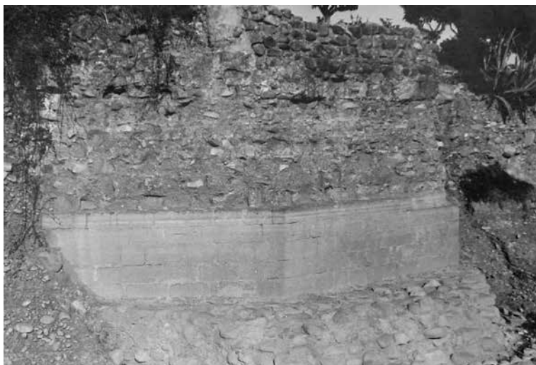
Fig. 13. Estribo del puente romano en la orilla septentrional del río. Fuente: archivo CAS.
