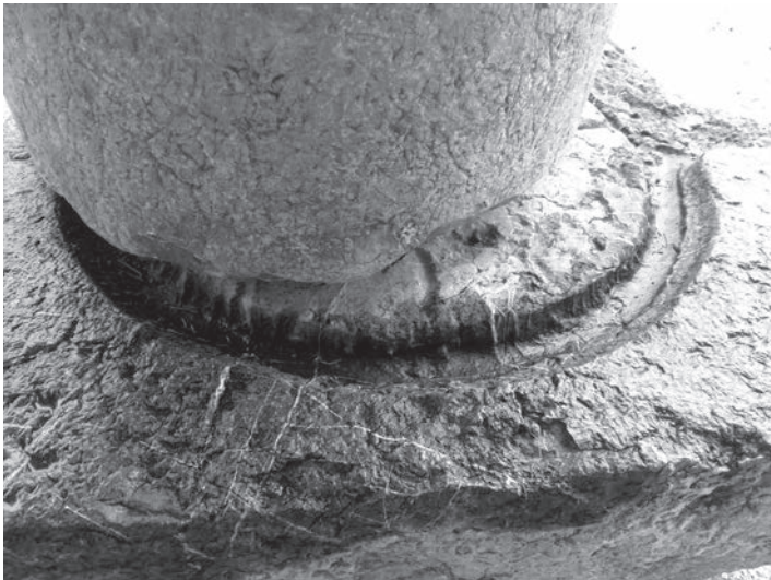
Fig. 5. Detall de les esquerdes sobre la roca.
