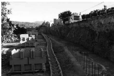
Cimentación, línea del nuevo muro y corte longitudinal del camino. Foto: Ayto Sagunto.
