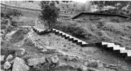
Imagen donde se muestra el solape de las traviesas para su trabado entre ellas y con la solera de regularización donde apoyan.
